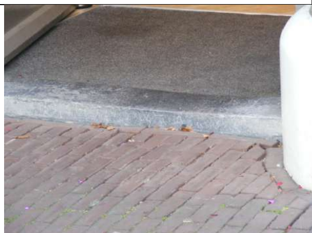
Drempels vormen een onneembare hindernis voor rollators en rolstoelen
